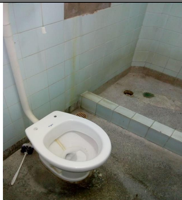
FOTO ANTES: SEM ASSENTO SANITÁRIO E TAMPA DE RALO
