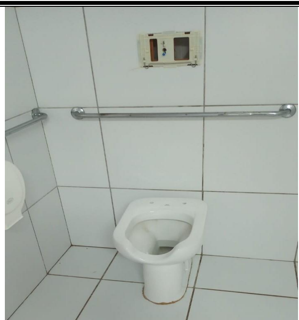
FOTO ANTES: SEM ASSENTO SANITÁRIO
