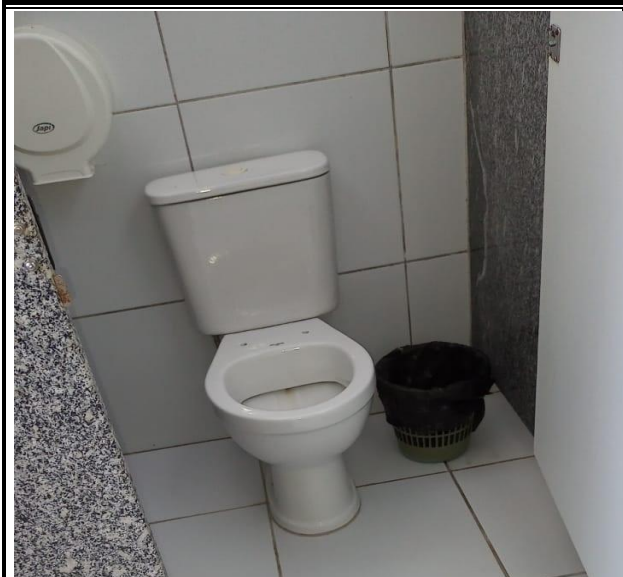
FOTO ANTES: SEM ASSENTO SANITÁRIO
