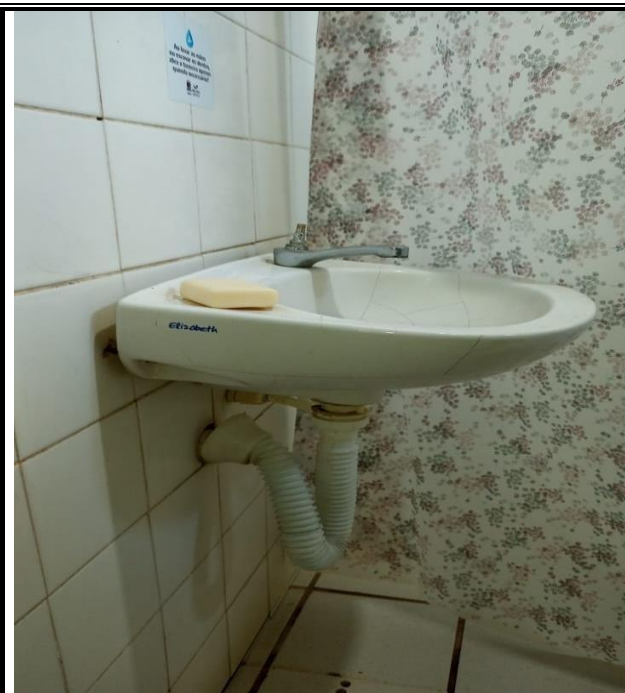
FOTO ANTES: TORNEIRA QUEBRADA, PIA, SIFÃO E ENGATE DANIFICADO
