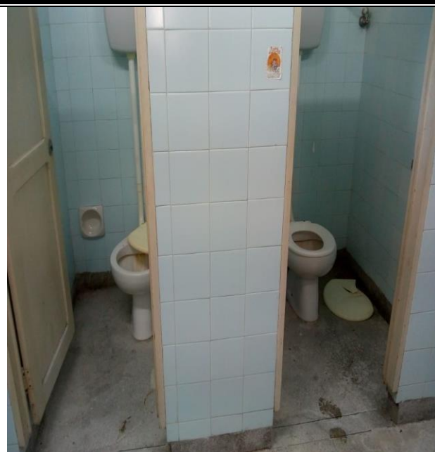
FOTO ANTES: ASSENTO SANITÁRIO DANIFICADO
