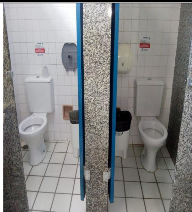
FOTO ANTES: SEM ASSENTO SANITÁRIO
