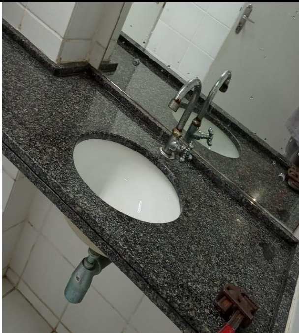
FOTO ANTES: TORNEIRA DANIFICADA
