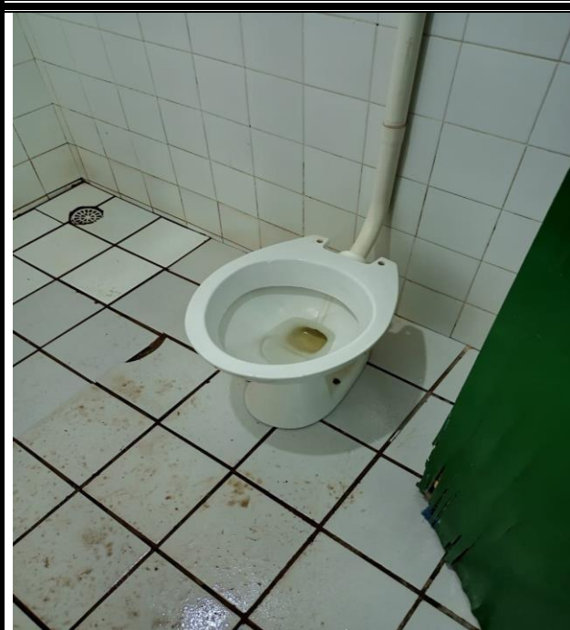
FOTO ANTES: SEM ASSENTO SANITÁRIO
