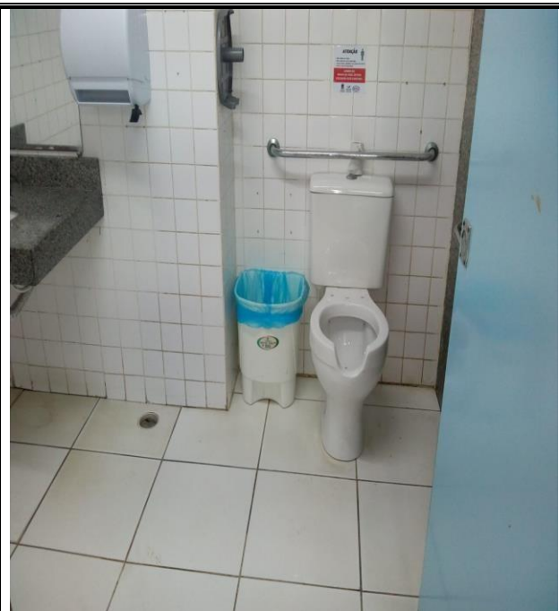
FOTO ANTES: SEM TAMPA DO RALO E ASSENTO SANITÁRIO
