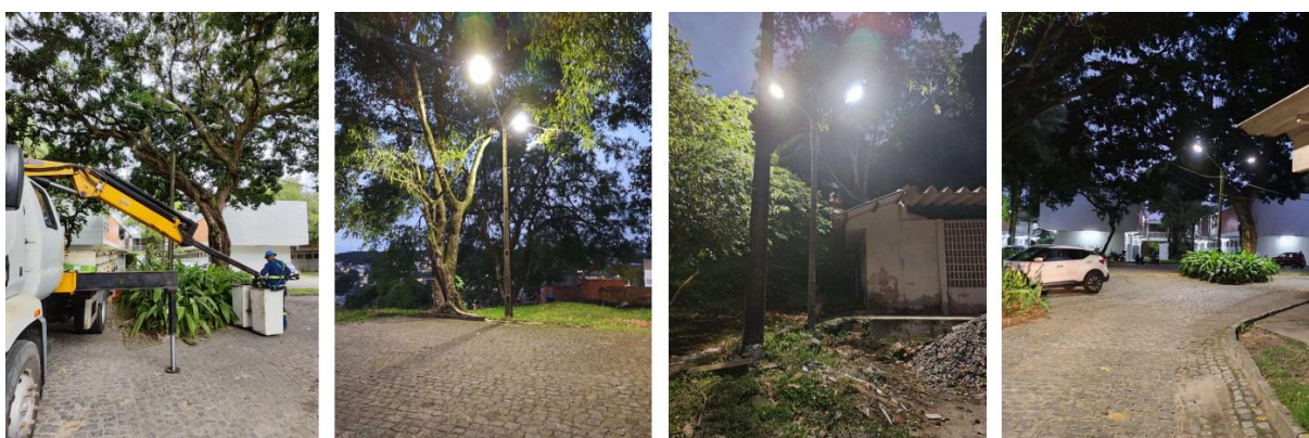
Figura 72 - Substituição de lâmpadas fluorescentes por LED
