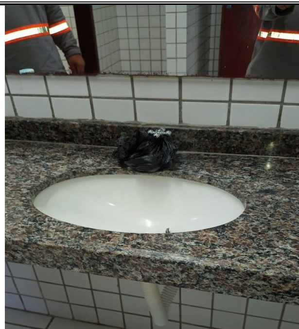
FOTO ANTES: TOREIRA DANIFICADA
