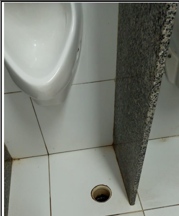
FOTO ANTES: SEM TAMPA DE RALO
