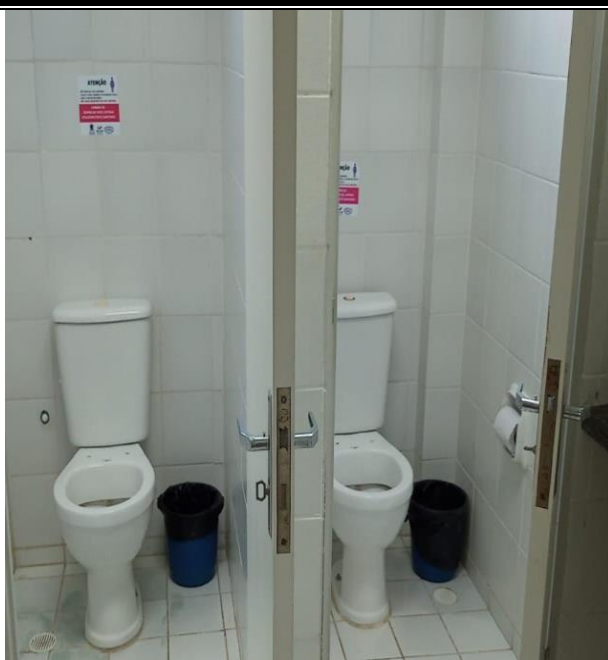
FOTO ANTES: SEM ASSENTO SANITÁRIO E REPARO DA DESCARGA QUEBRADA
