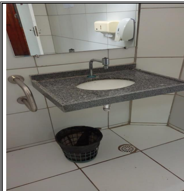
FOTO ANTES: TORNEIRA QUEBRADA
