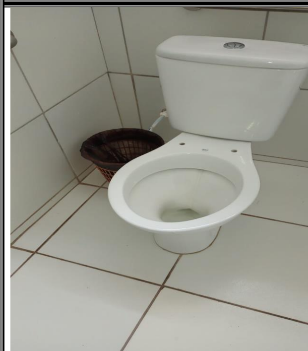
FOTO ANTES: SEM ASSENTO SANITÁRIO
